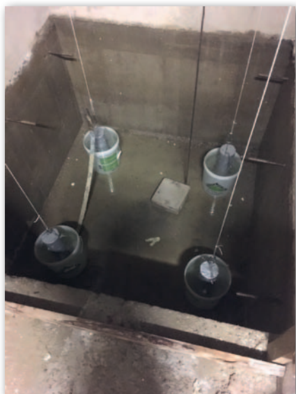
Fot. 5. Obciążone pionów w podszybiu
