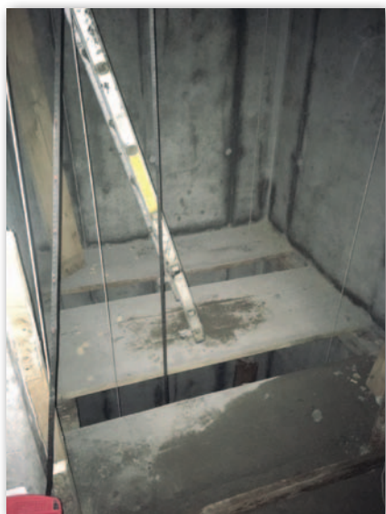
Fot. 6. Opuszczona ruletka w szybie
